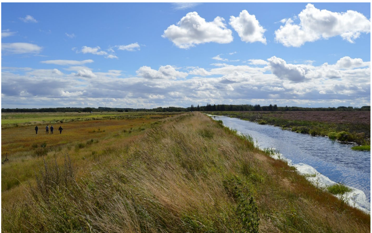
Jordvold med plastikmembran adskiller nu højmosen fra landbrugsarealer. August 2020. Foto: Frank Bondgaard, SEGES.
